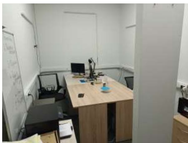
Фото 30. Состояние помещений антресоли 1 этажа
